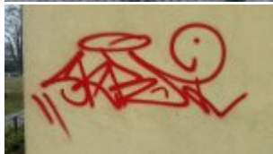
Jedna ze zniszczonych elewacji
