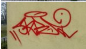
Jedna ze zniszczonych elewacji
